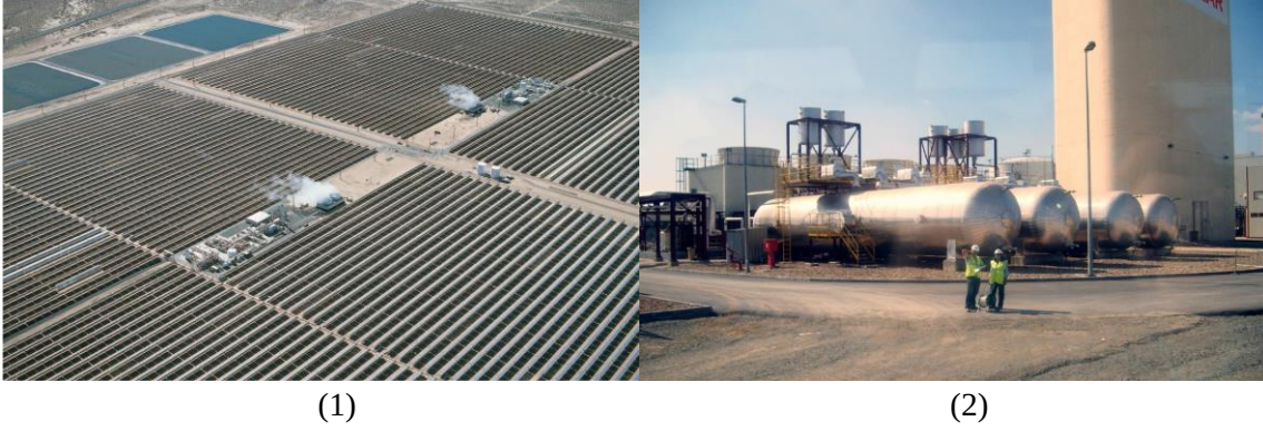
Resim 21 CSP Santrali Isı Depolarının ve Soğutma Kulelerinin Görünümü(57)
