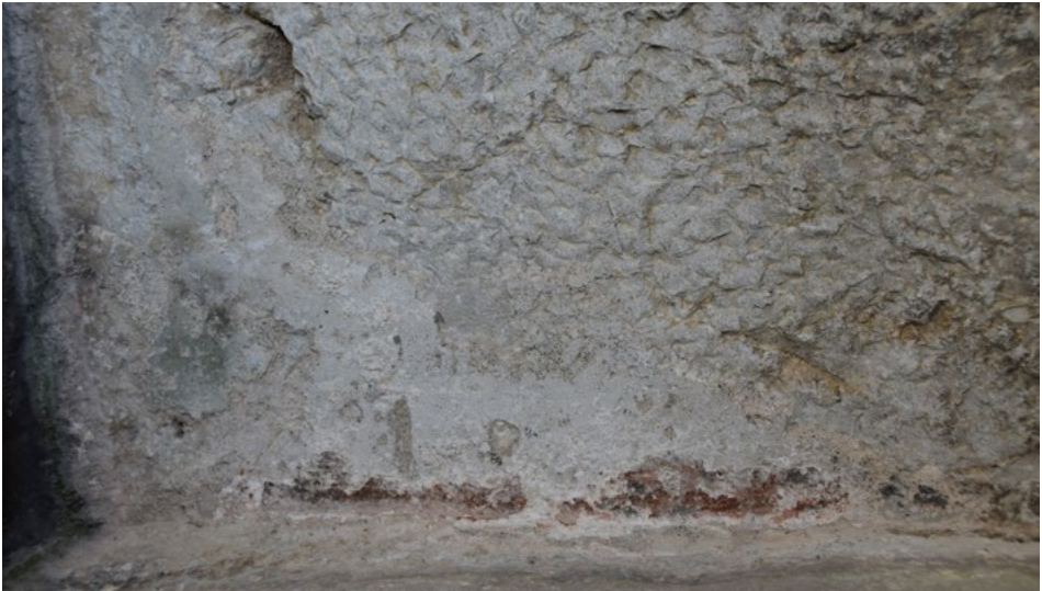
Resim 273: Duvarda korunan boyalı sıva izi.
