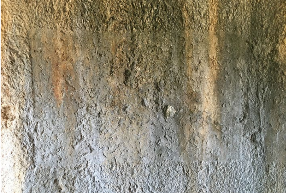
Resim 258: Batı duvarında güneyde yer alan boş pano.
